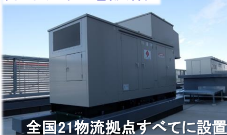
非常用発電設備
