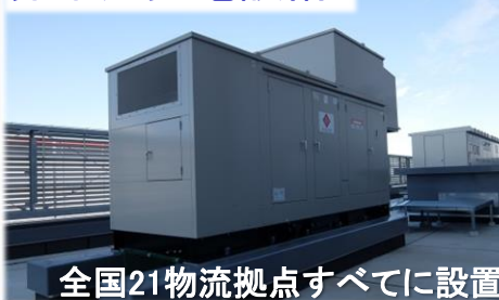
非常用発電設備
