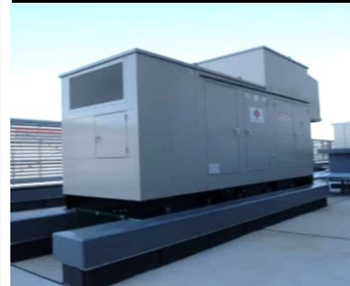
非常用発電設備
